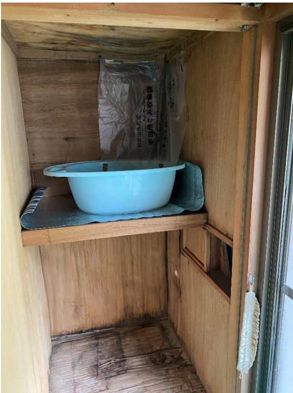
押し入れ (雨漏り部分)
