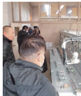
制御盤（里浄水場）
